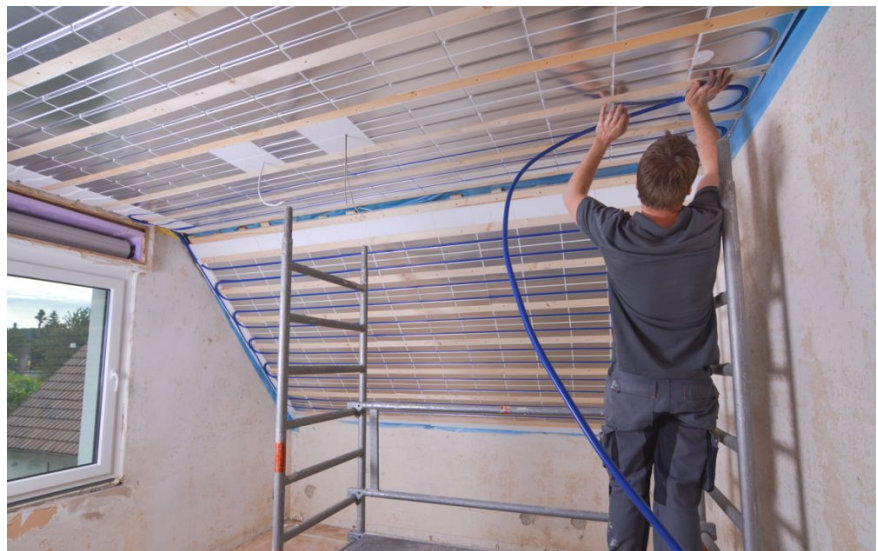
Die Omega-Rohrkanäle halten das Rohr an der Decke
