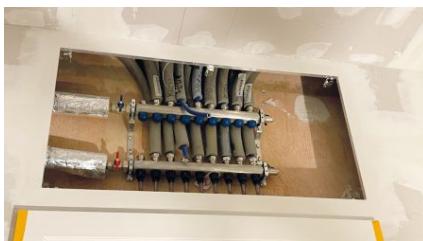
Heizkreisverteiler für die Deckenheizung/ -kühlung
