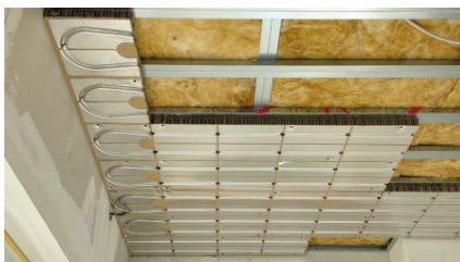
Heizelemente im Profil verschraubt
