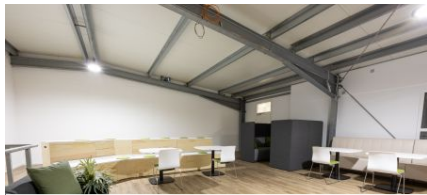
Modernes Raumdesign: Großflächige Strahlungswärme sorgt für eine behagliche Pausenumgebung
